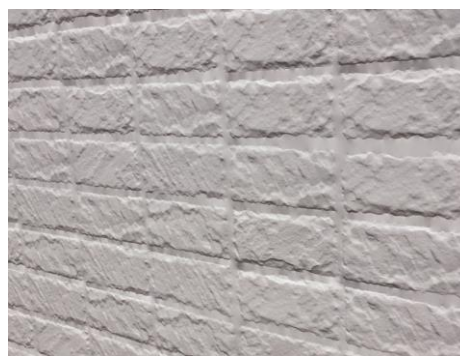
目地部分施工の悪い例
